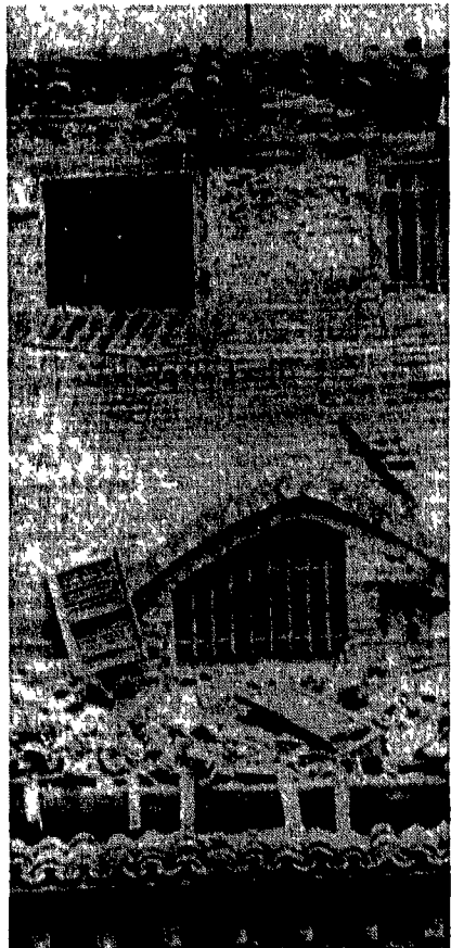
Il tetto crollato di una vecchia casa
