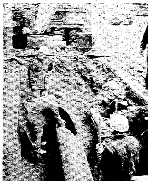
I tecnici controllano la tubatura rotta
