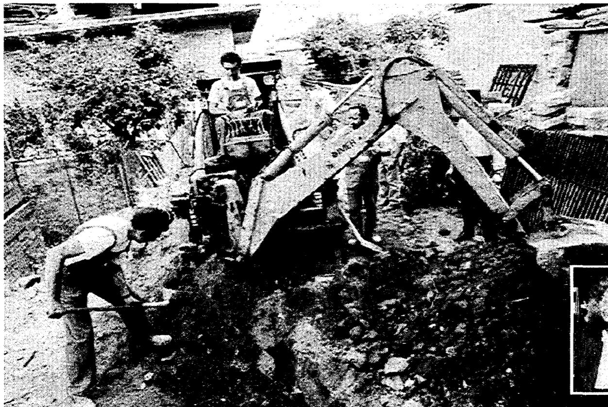
Gli scavi nel giardino della villetta di Acilia. Nella foto piccola il pm Diana De Martino
