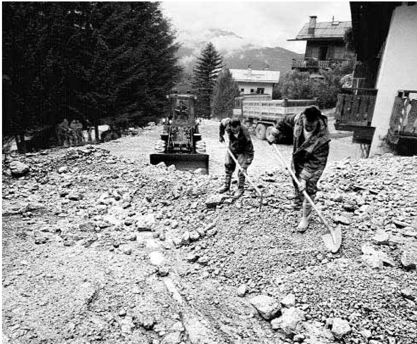
Volontari della protezione civile rimuovono il fango che ha invaso uno dei paesi del Cadore
