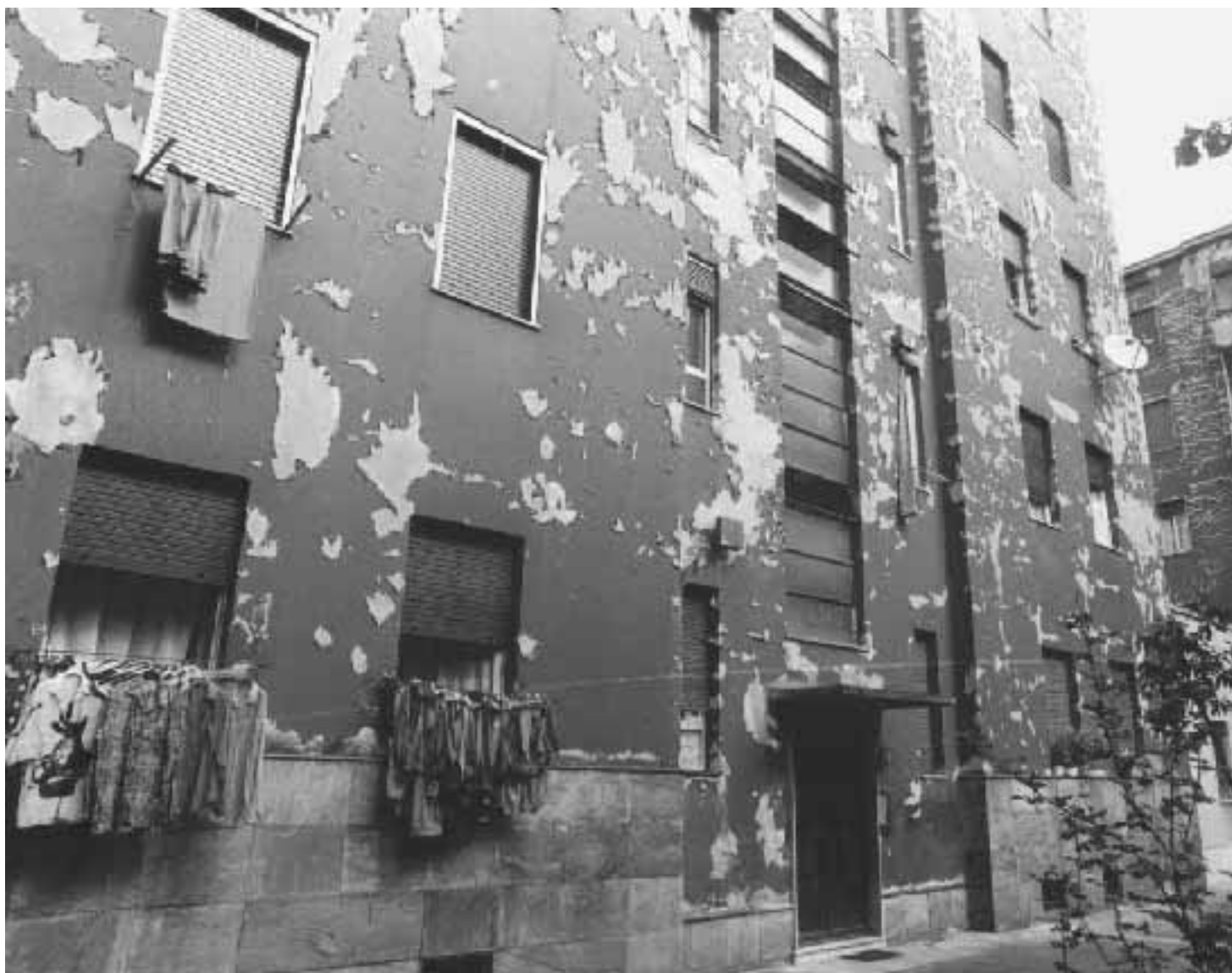
Lo stato di degrado delle case Iacp di via Paravia
