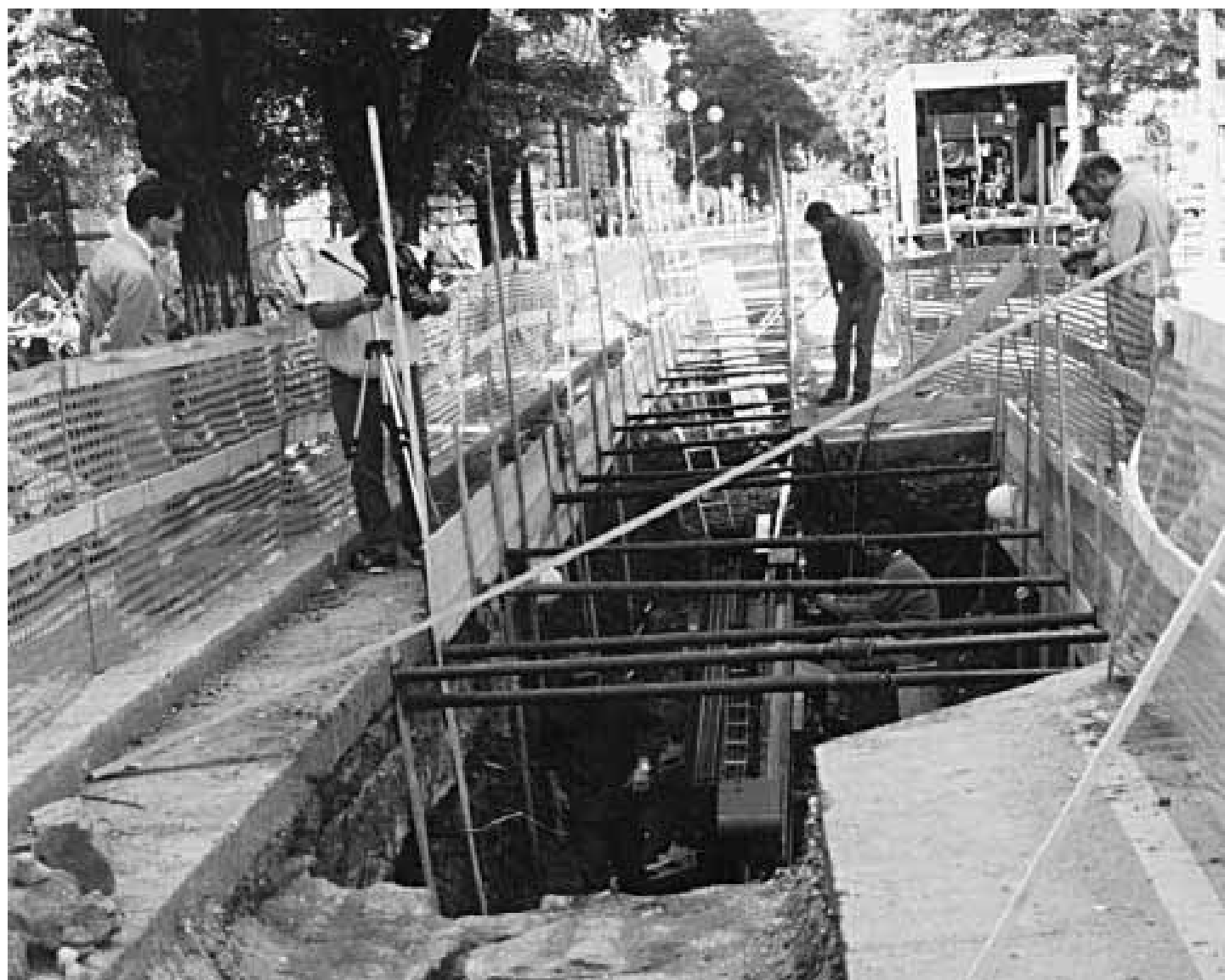
Uno scavo per la posa della rete elettrica dell'Enel, in basso il mosaico rinvenuto durante i lavori
