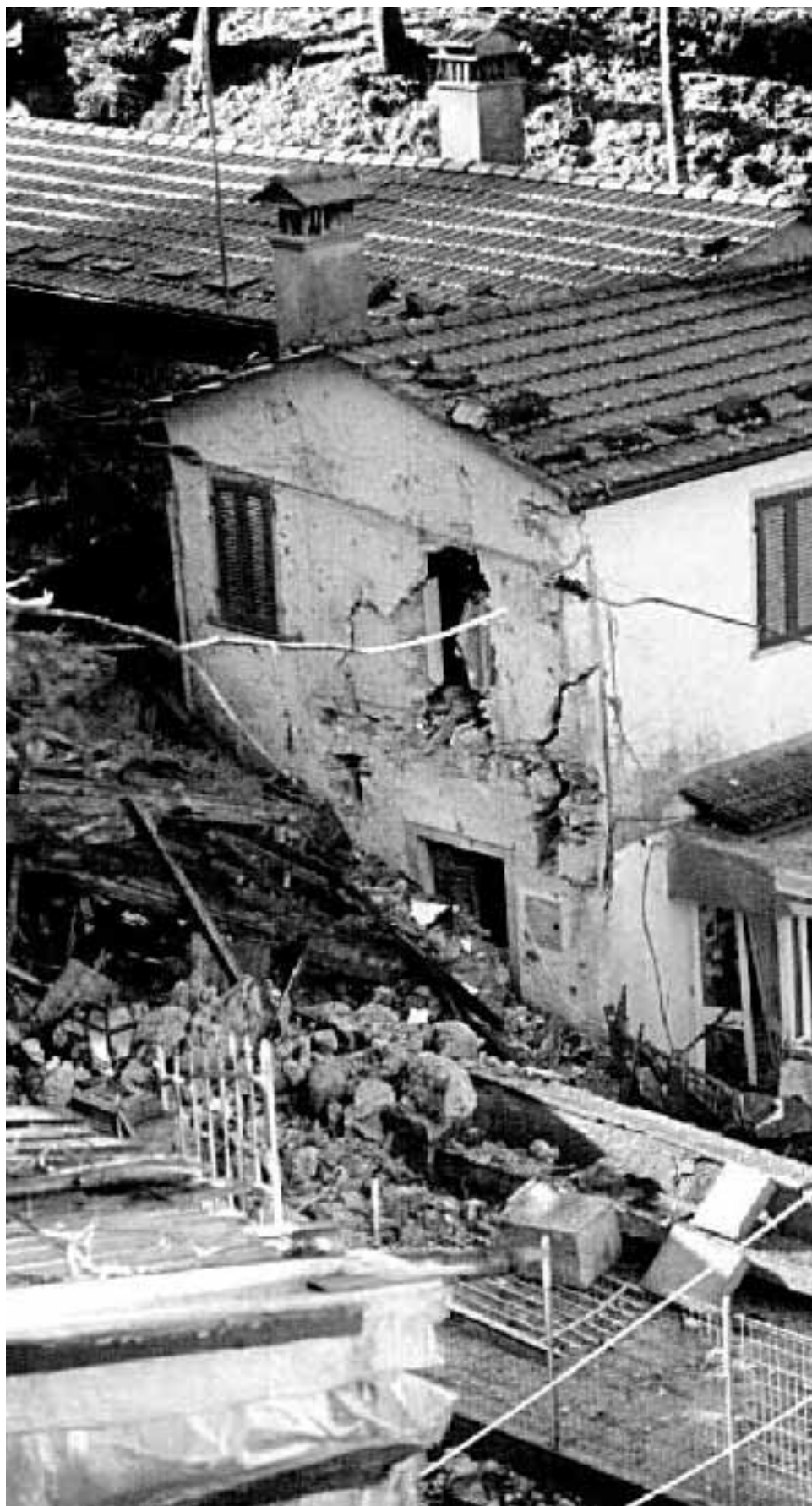
Un edificio in Versilia gravemente danneggiato da uno smottamento del terreno R. Delle Luche/Ansa
