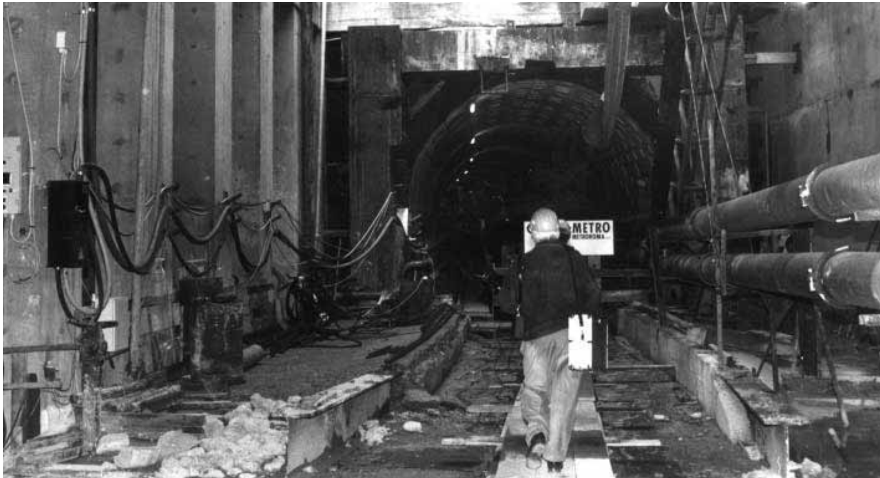
Il cantiere per il prolungamento della metro A nei pressi della futura stazione «Valle Aurelia»
