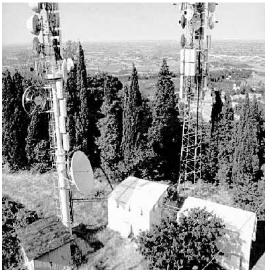
Ripetitori e antenne di telecomunicazione della Telecom
