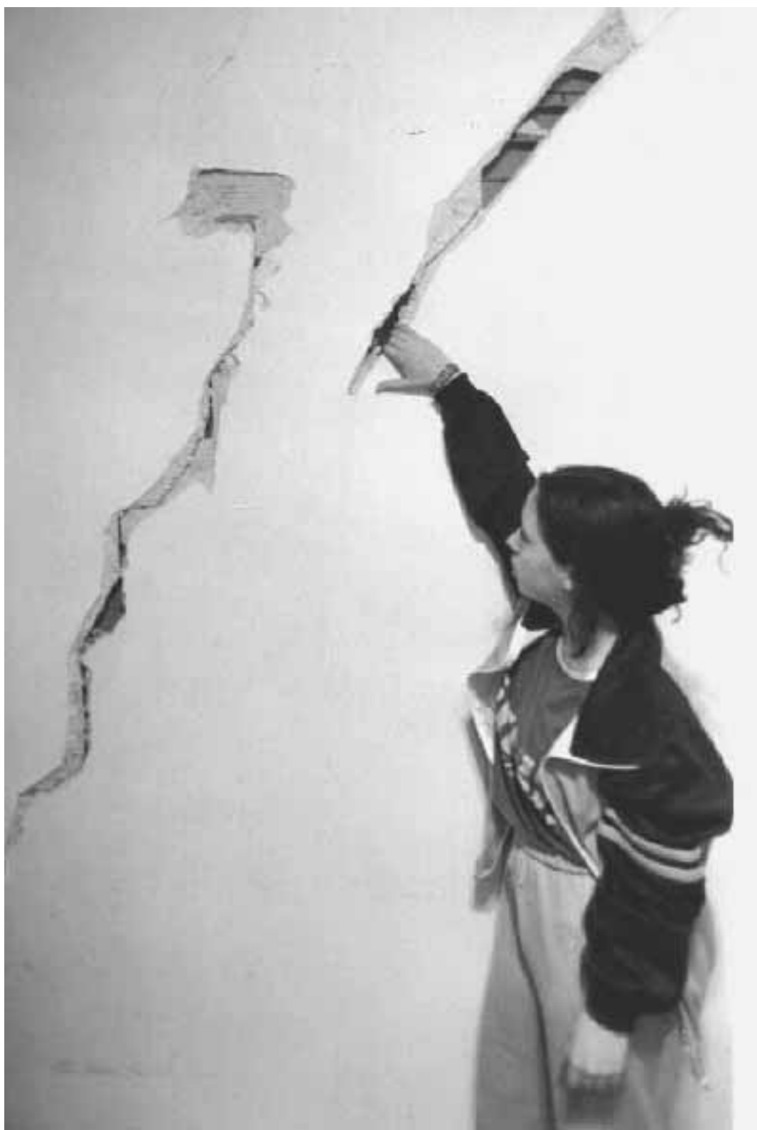
Una parete rovinata dalle crepe in uno degli appartamenti di via Tofano al 5
