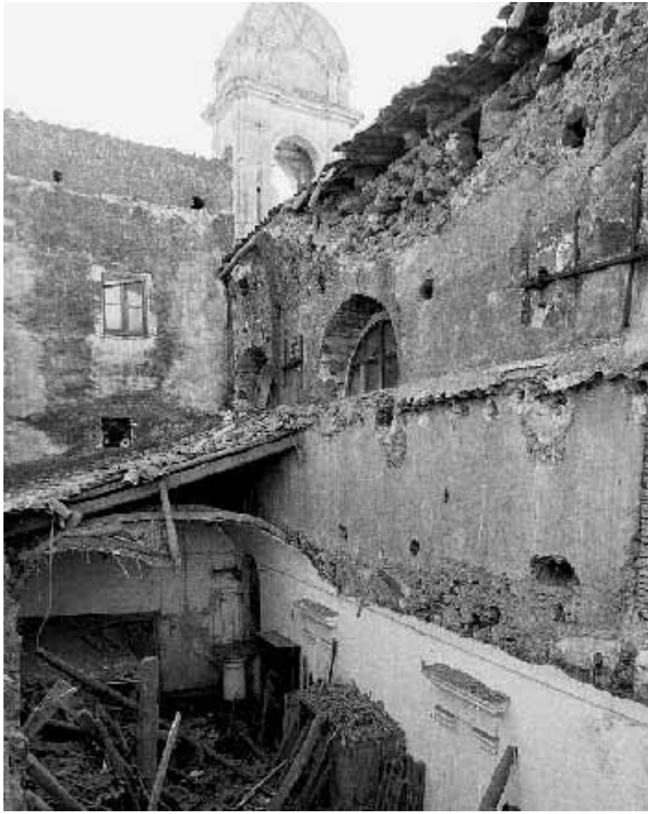
Il crollo del tetto della chiesa della Madonna del Rosario di Biancavilla
