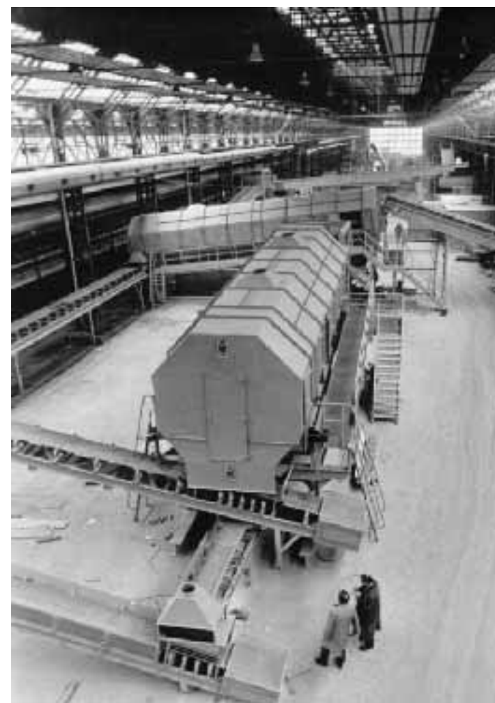
L'impianto di trattamento dei rifiuti all'ex Maserati
