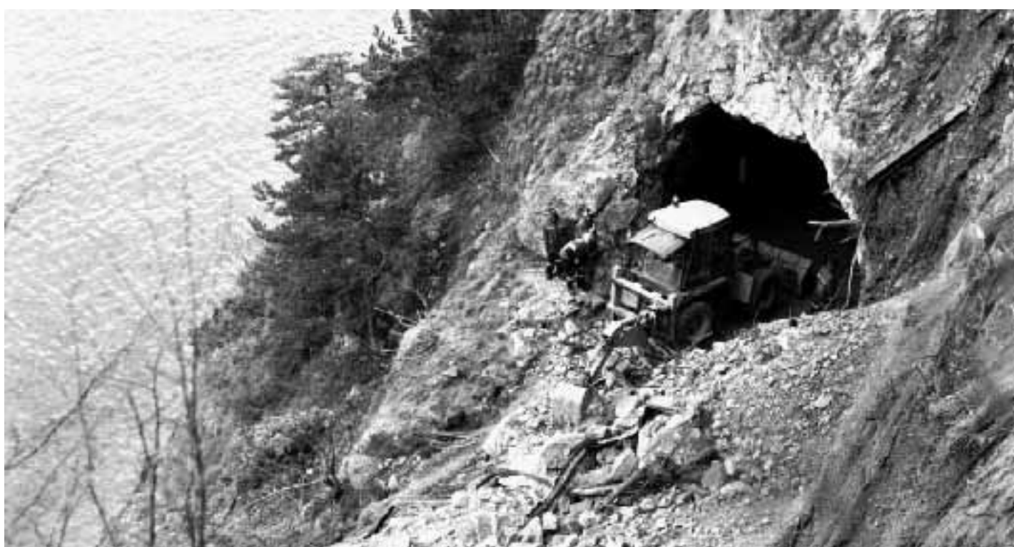
Si continua a scavare sul luogo della frana a Riva del Garda
