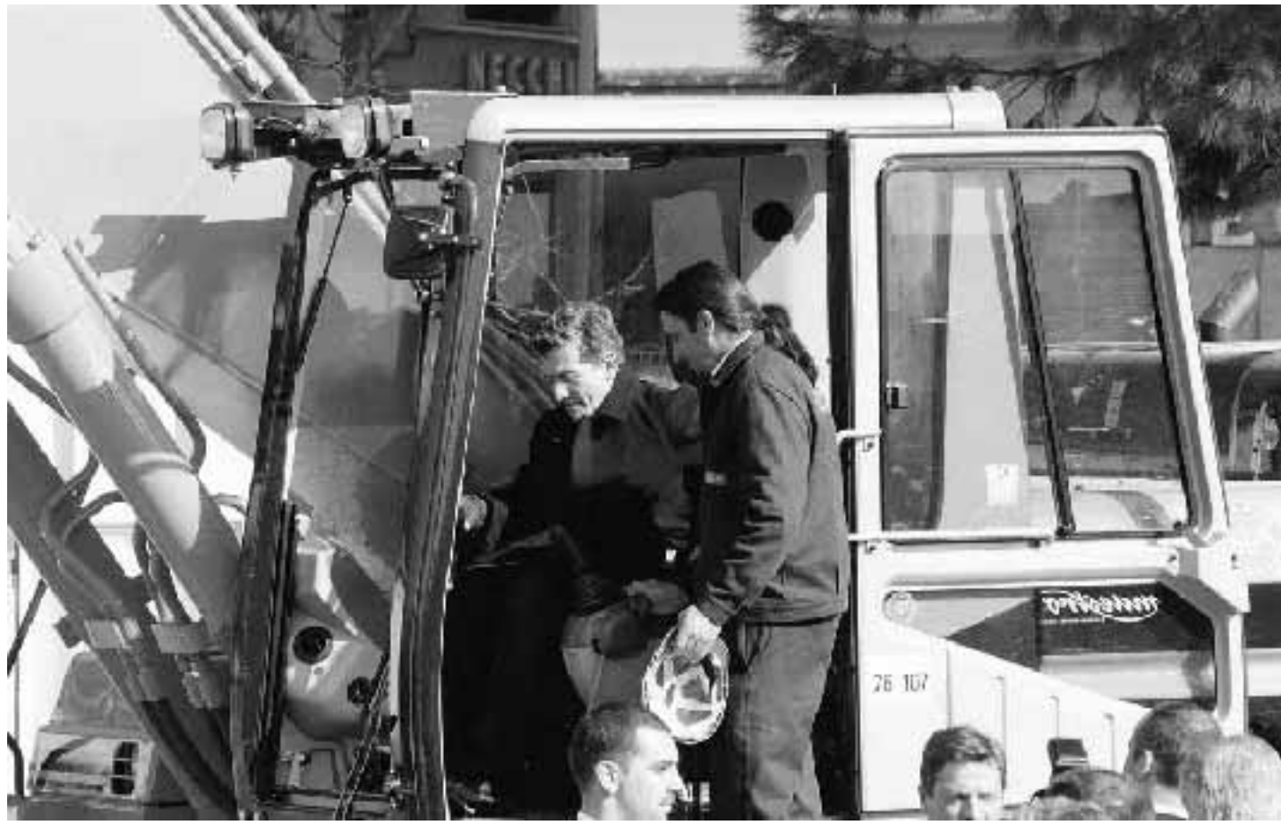
Massimo D'Alema, a bordo di un bulldozer, dà il via alla realizzazione della Lungo Irno, nuova arteria stradale di Salerno
