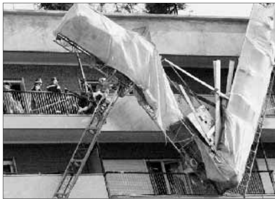
I vigili del fuoco soccorrono un operaio che stava lavorando al rifacimento della facciata di una palazzina, qualche tempo fa a Torino e che è rimasto per due ore sospeso in aria Ansa
