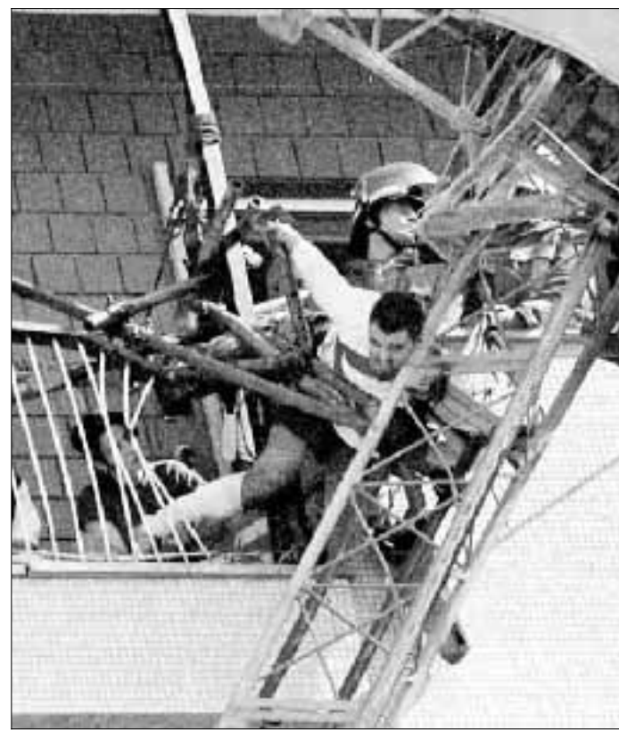
I vigili del fuoco soccorrono un operaio su un'impalcatura
