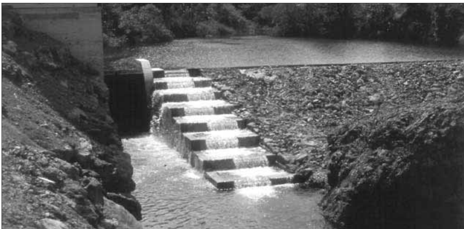
Lo sbarramento in cemento sull'Aveto. Gli «scalini», alti ben 40 centimetri, dovrebbero consentire ai pesci di risalire la corrente
