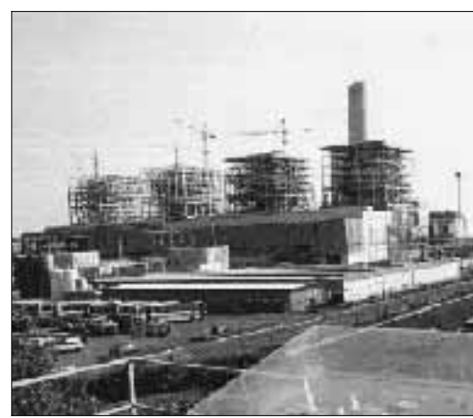
La centrale Enel di Montalto di Castro
