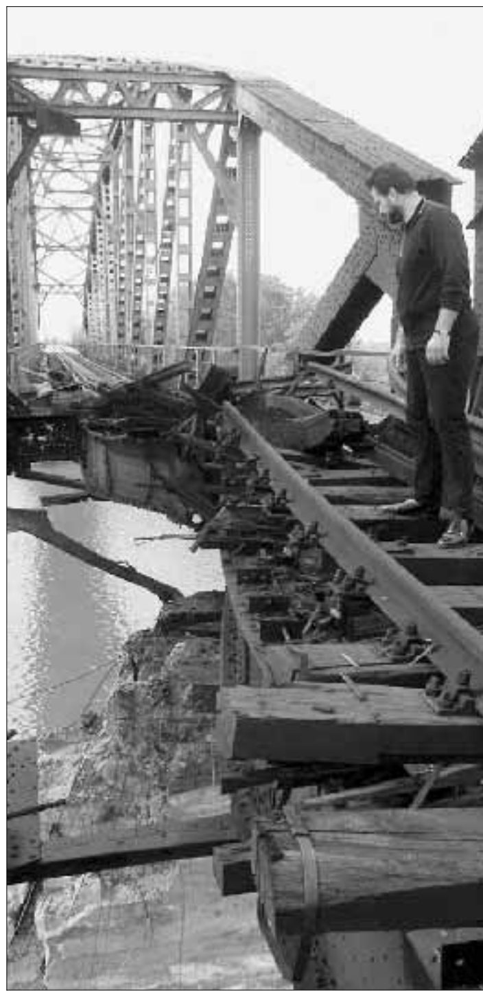
Un ponte distrutto dal bombardamento della Nato sul fiume Sava Ap
