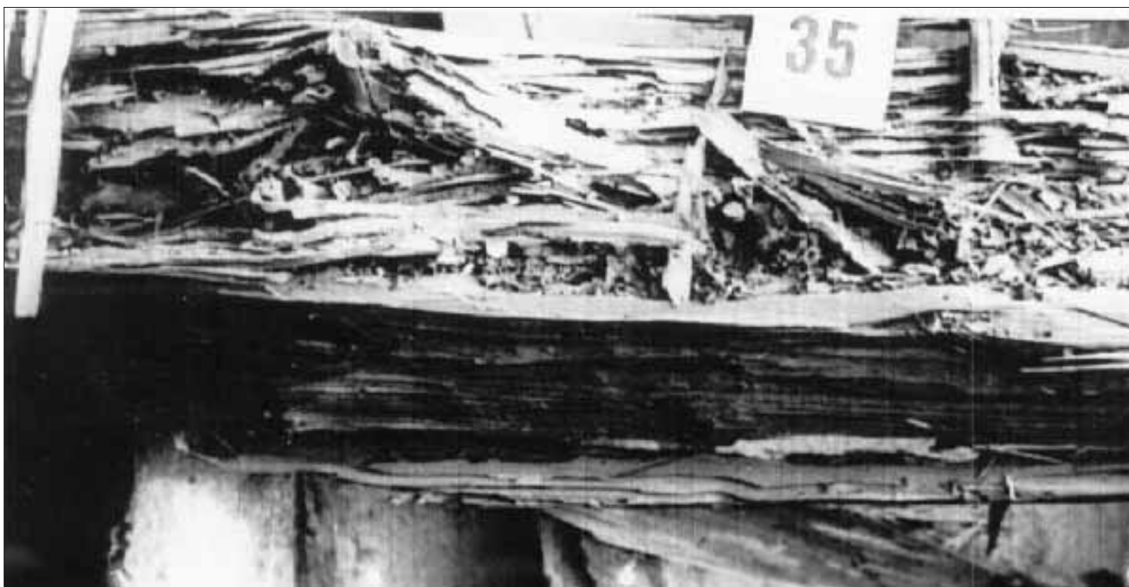
Una delle travi in legno del Duomo di Monreale attaccate dalle termiti
