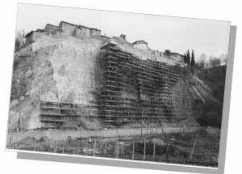
Consolidamento parete rocciosa a salvaguardia dell'abitato di Linaro (FO) (Ancoraggi - tiranti e spritz-beton)
