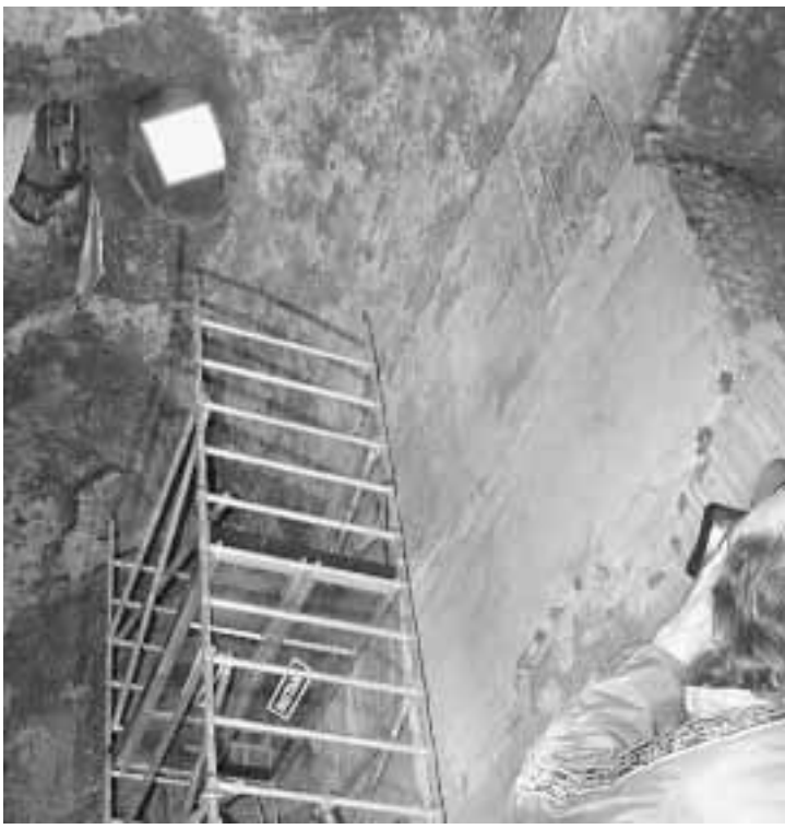
Il foro nella volta della Sala Ottagona della Domus Aurea Borgia/Ap
