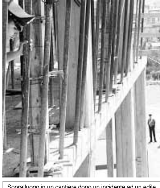
Sopralluogo in un cantiere dopo un incidente ad un edile
