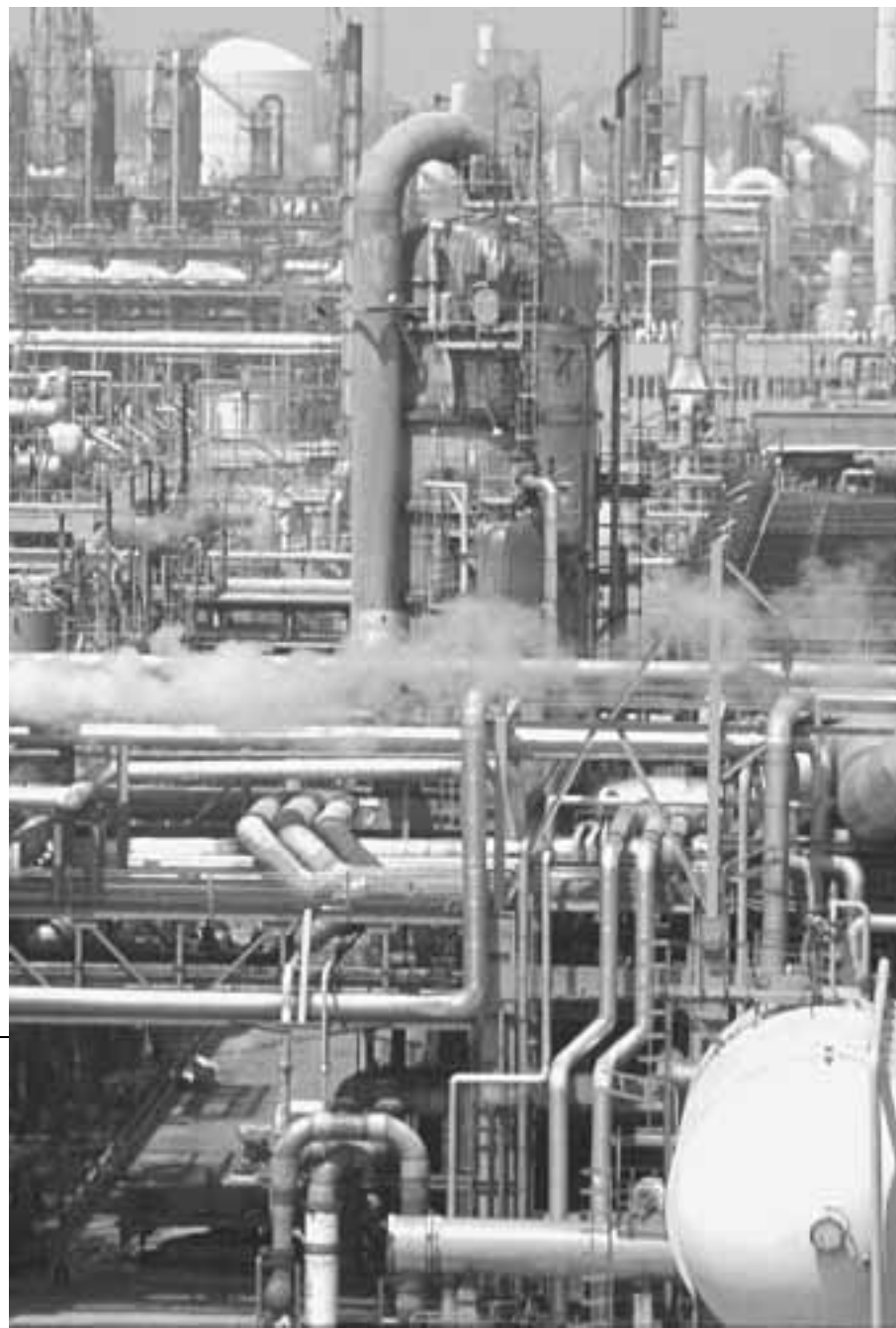
L'interno di uno stabilimento chimico dell'Enichem
