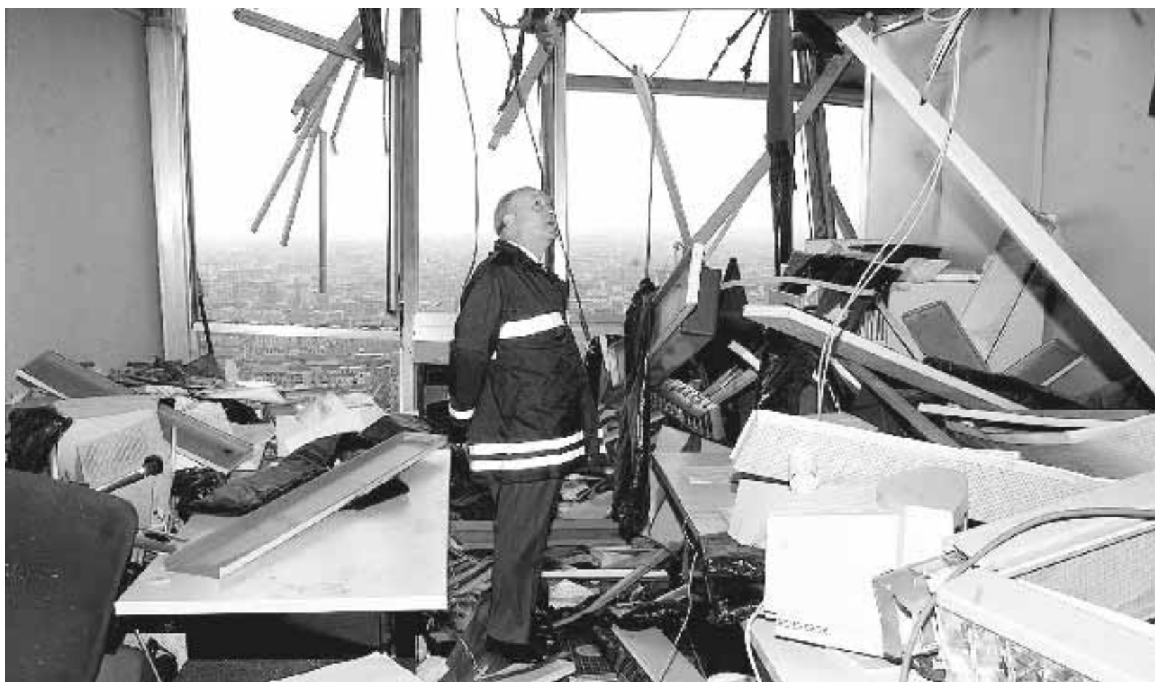
I Vigili del fuoco sono ancora al lavoro all'interno di uno degli uffici del 25 piano del Pirellone di Milano per controllarne l'agibilità. D. Dal Zennaro/Ansa
