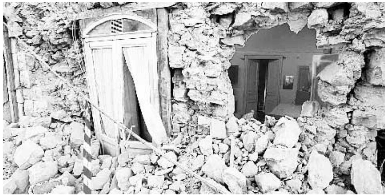
I resti di una delle case di San Giuliano di Puglia gravemente danneggiate dal sisma Ciro Fusco/Ansa
