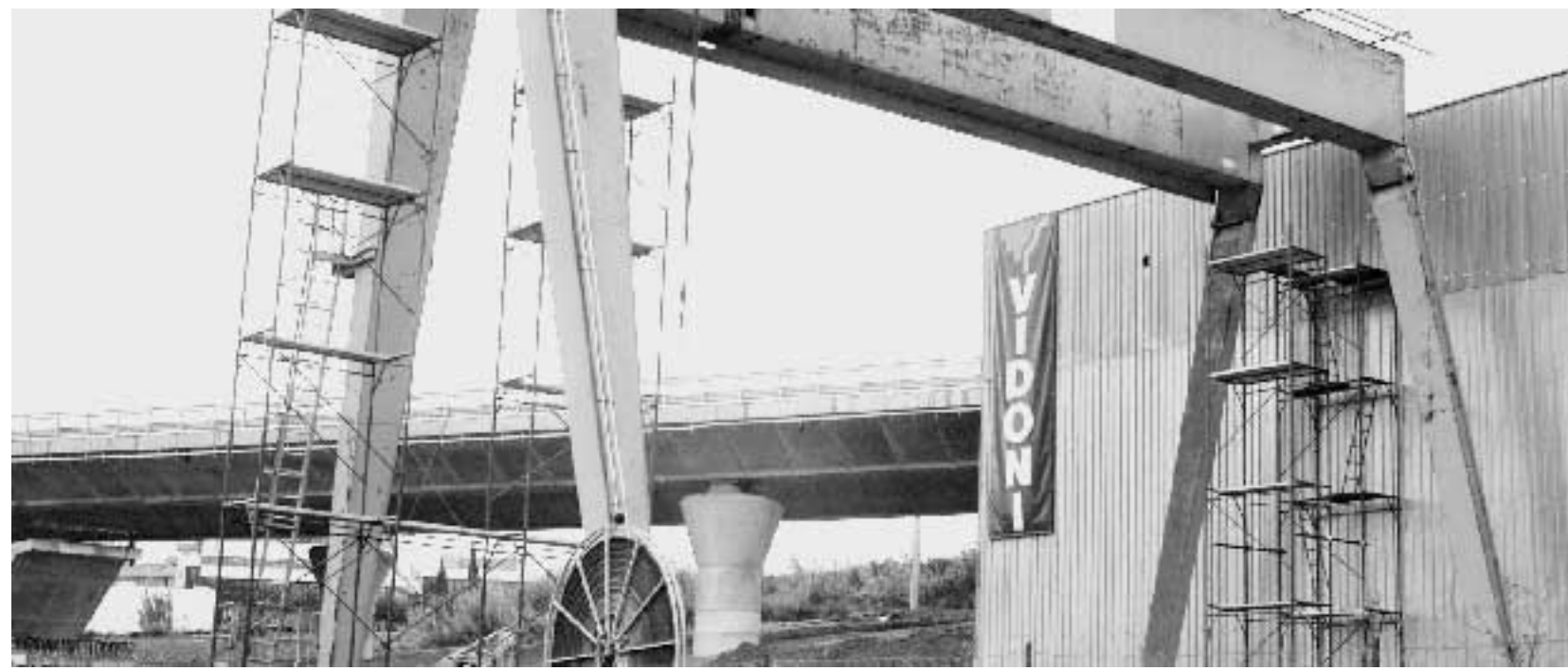
Una impalcatura della ditta Vidoni una delle dodici imprese edili coinvolte nell'inchiesta della Procura distrettuale di Catanzaro sulle infiltrazioni mafiose nei lavori di ammodernamento del tratto cosentino dell'autostrada A/3
