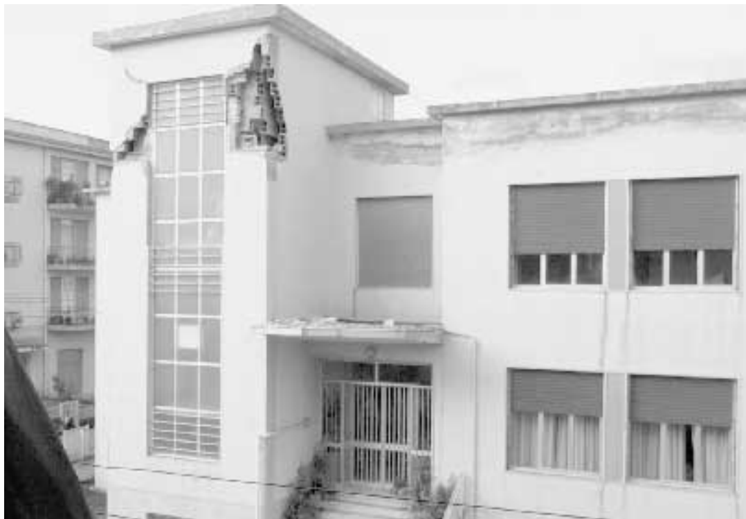
L'esterno pericolante di una scuola a Giarre, in Sicilia
