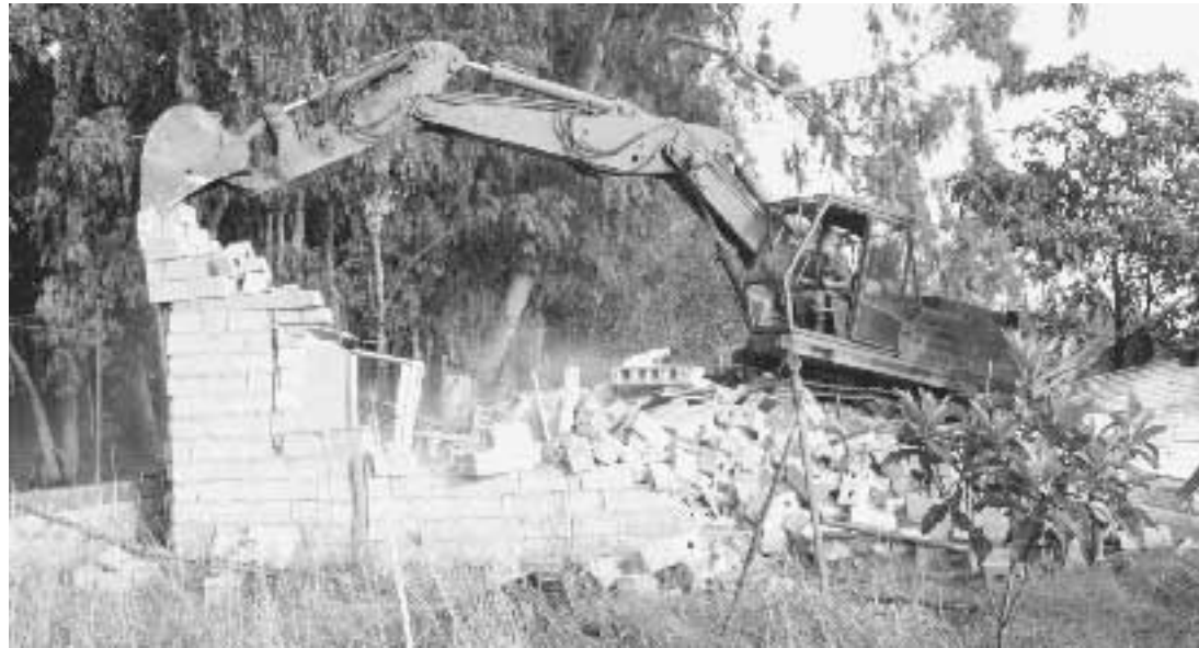
L'abbattimento di una villetta abusiva a Eboli. P. Stanzione / Ansa
