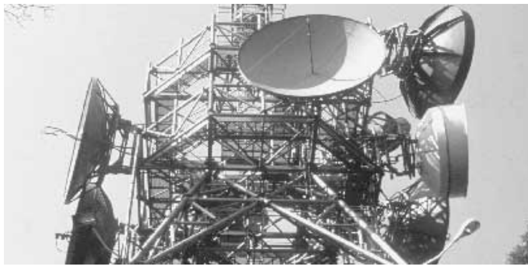
Alcuni ripetitori installati vicino ai centri abitati
