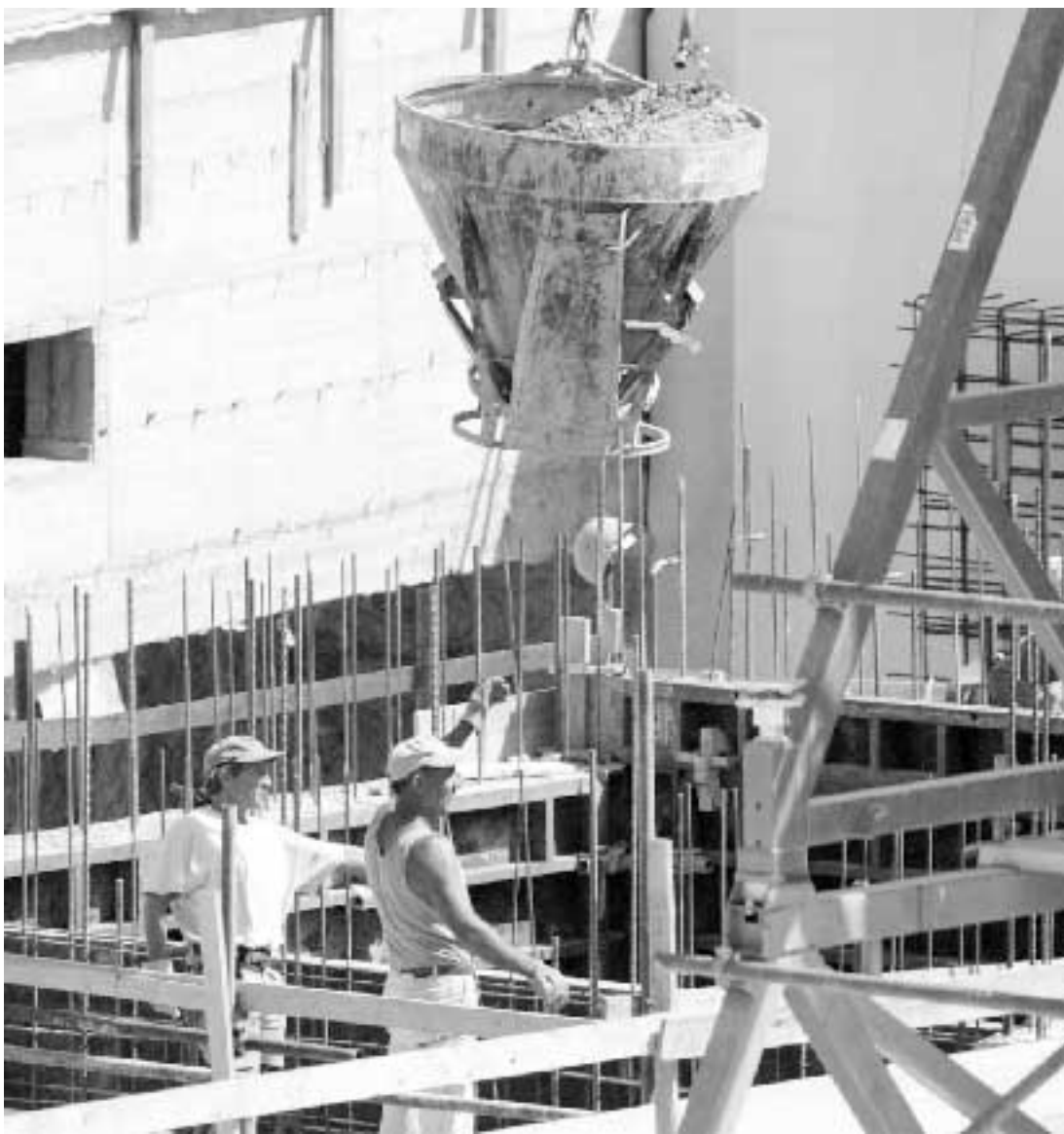
Operai in un cantiere senza le misure di sicurezza
