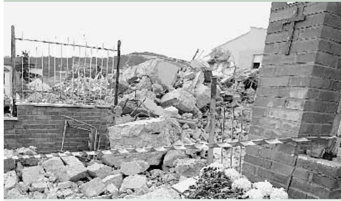
Le macerie della scuola di San Giuliano
