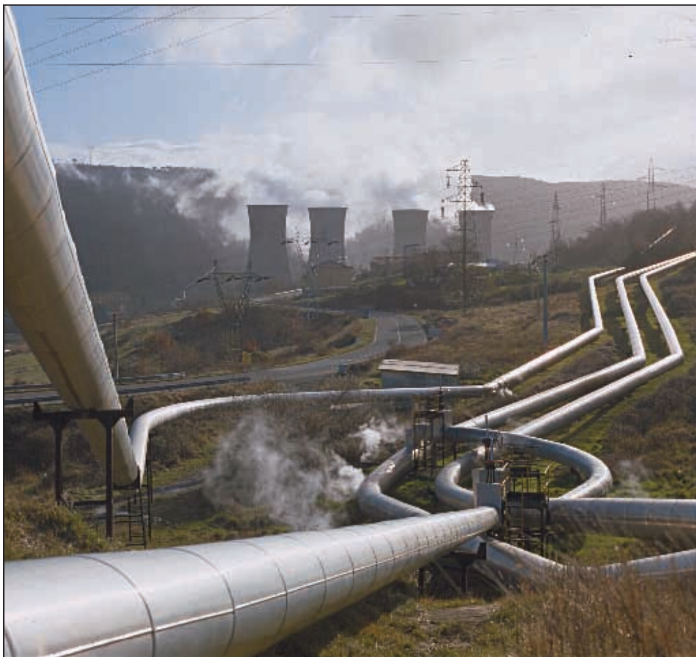
“Una centrale geo termica di Lardarello in Toscana”
