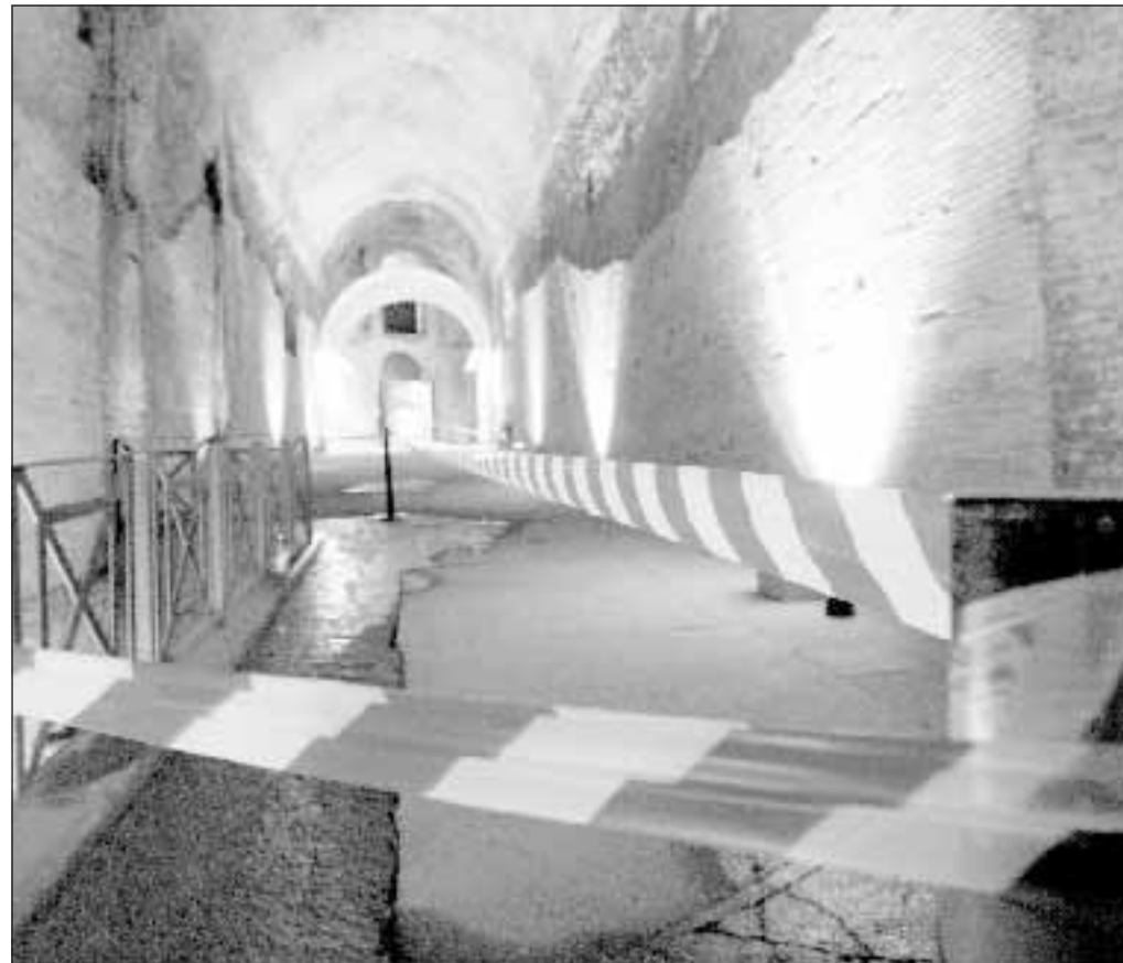
Un corridoio della Domus Aurea trasennato per la minaccia di crolli: per restauri e manutenzione non ci sono più soldi
