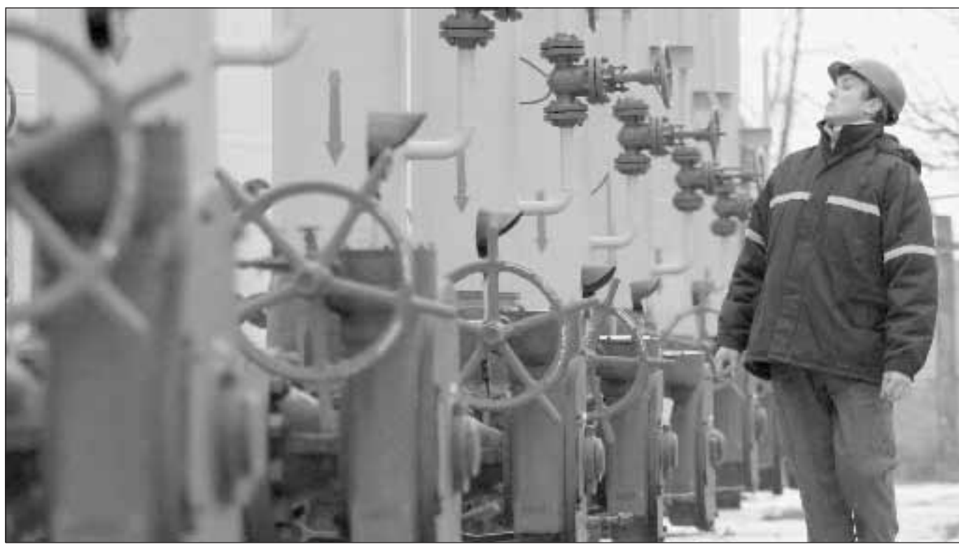
Un impianto di stoccaggio del gas. Foto Ansa
