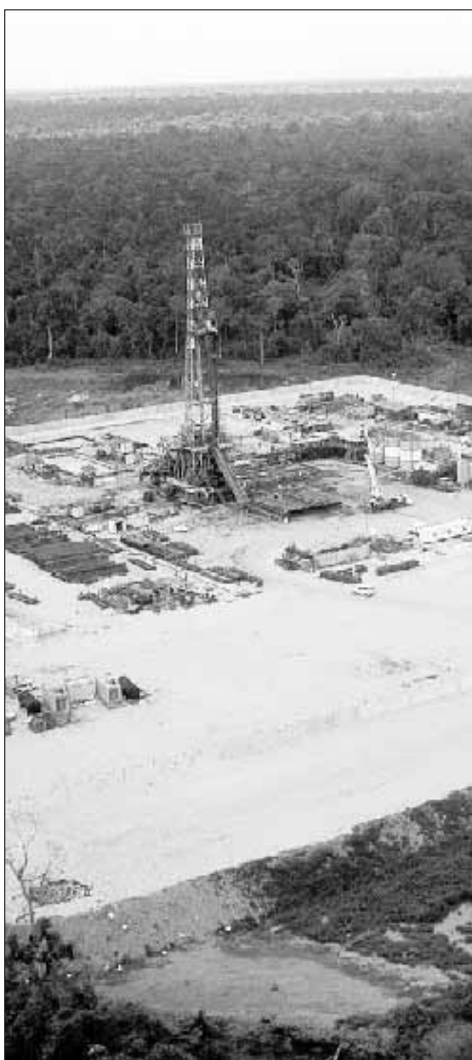
L'impianto dell'Agip sul delta del Niger Foto Ansa
