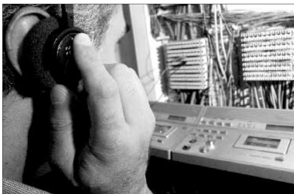
Un operatore al lavoro in una centralina telefonica. Foto Ansa
