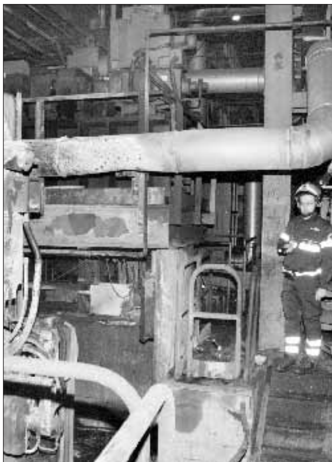
Vigili del Fuoco ispezionano il reparto termico dove è divampato il rogo. Foto Ansa
