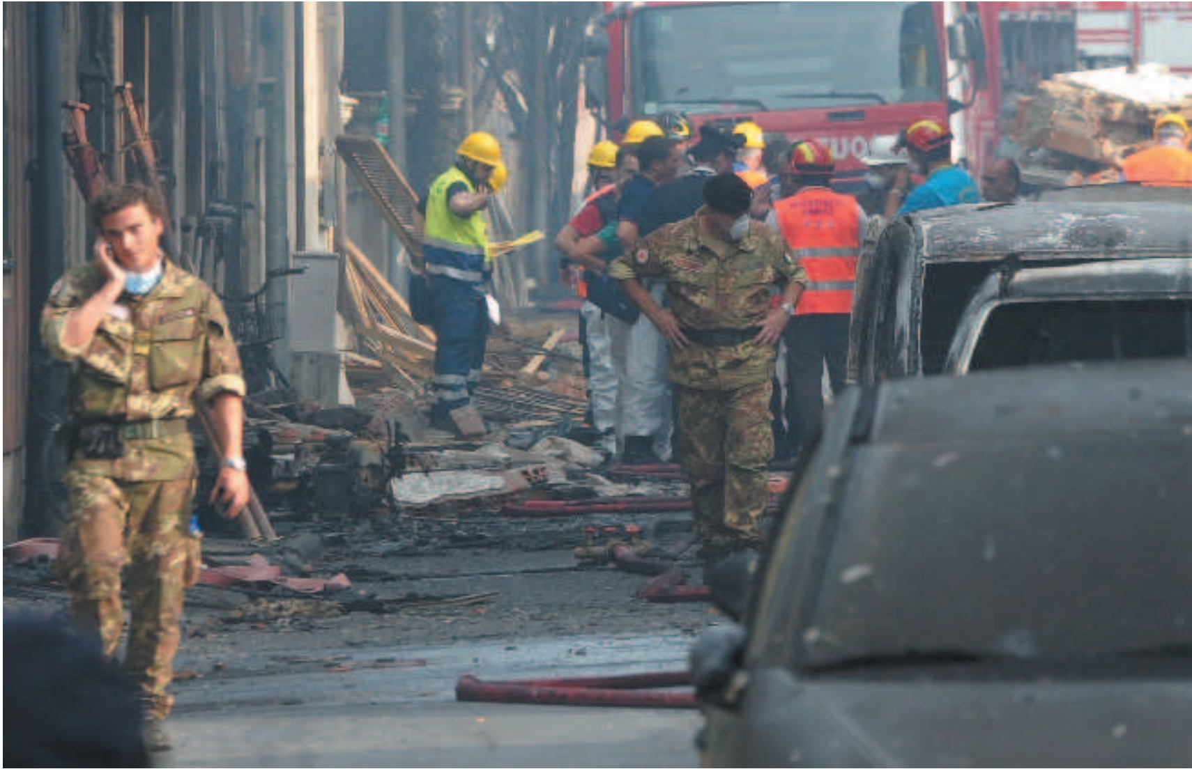
Il via vai dei soccorsi: si continuerà anche oggi a scavare sotto le macerie
