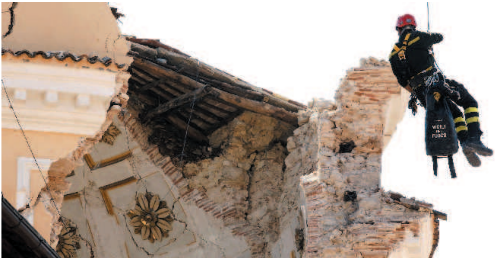
I primi interventi sulla volta della basilica di Santa Maria di Collemaggio crollata nel punto in cui è sito il mausoleo di Celestino V
