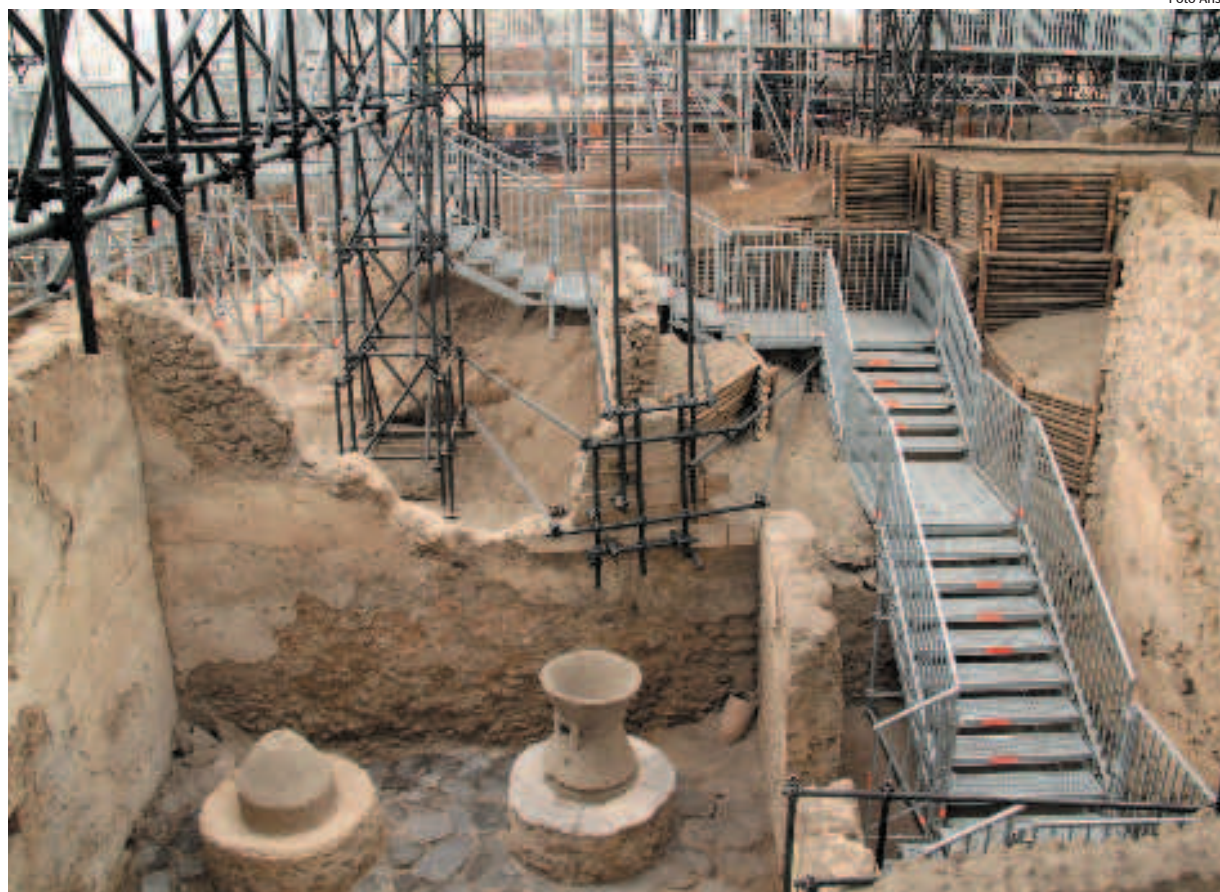
18 gennaio 2010 Durante i lavori di restauro una gru crolla sulle strutture della Casa dei Casti Amanti facendo crollare un muro
