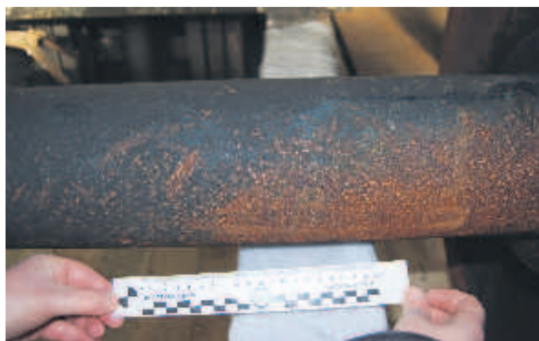
Un particolare dell'asse corroso
