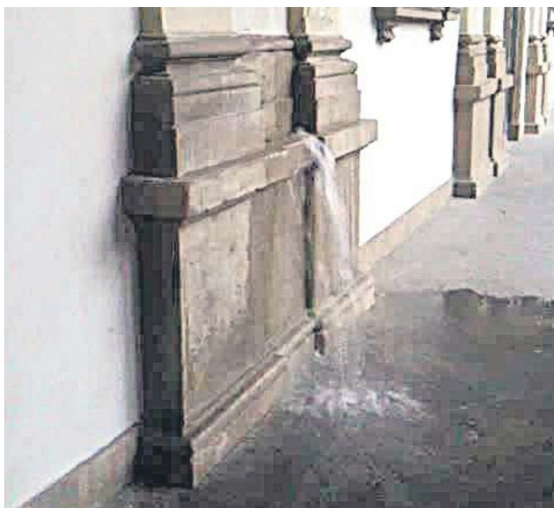
L'acqua che esce dalla parete sul loggiato di Brera, nel filmato girato dai tecnici Uil
