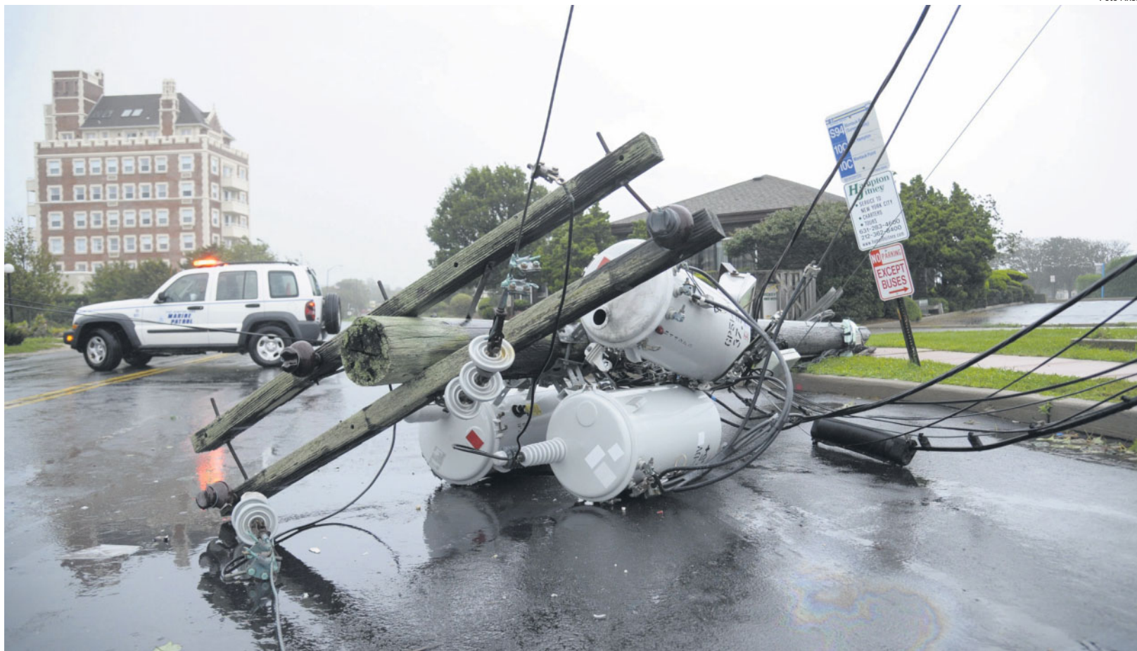
Linee elettriche danneggiate a Long Island
