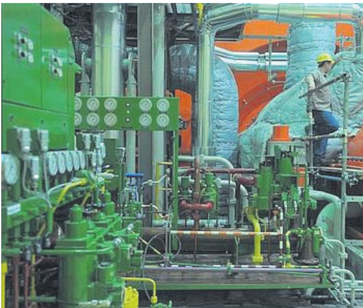
L'interno della centrale belga
