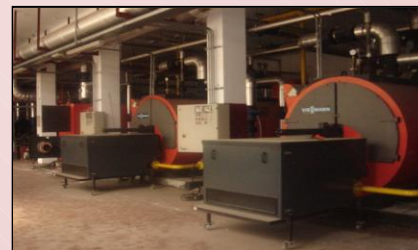
ALDINI II NEL 2011 CON COGENERAZIONE
