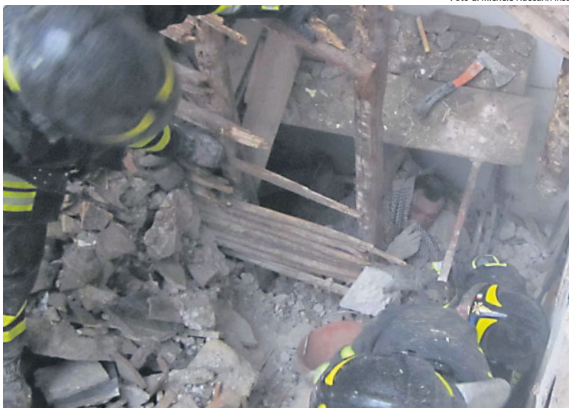
Una delle fasi del salvataggio dell'operaio rimasto tre ore sotto le macerie a Palermo
