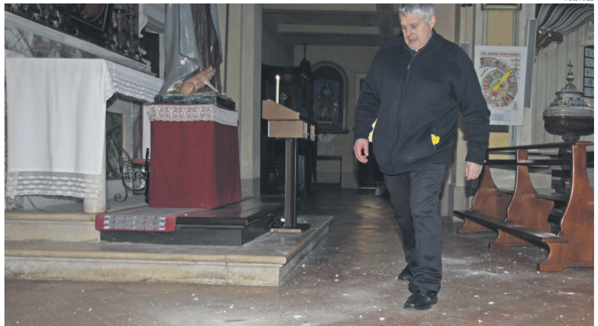
Don Giovanni Davoli mostra i calcinacci caduti all'interno di Santa Maria Nascente a Brescello, la chiesa di "Don Camillo"
