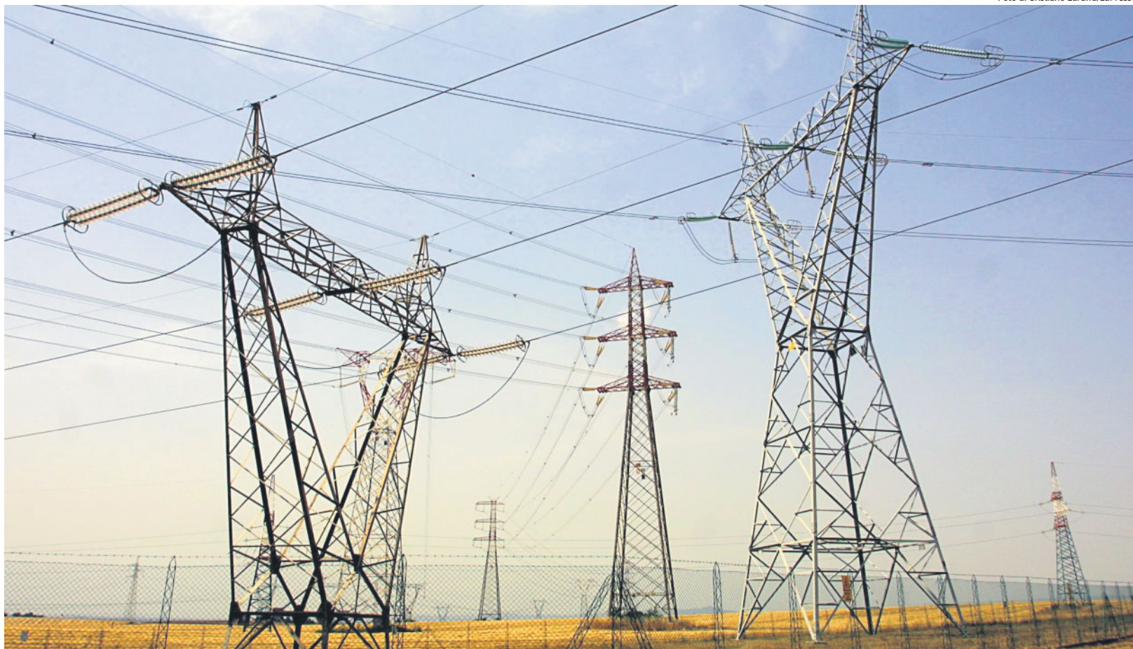
Tralicci della centrale Enel della Marcigliana
