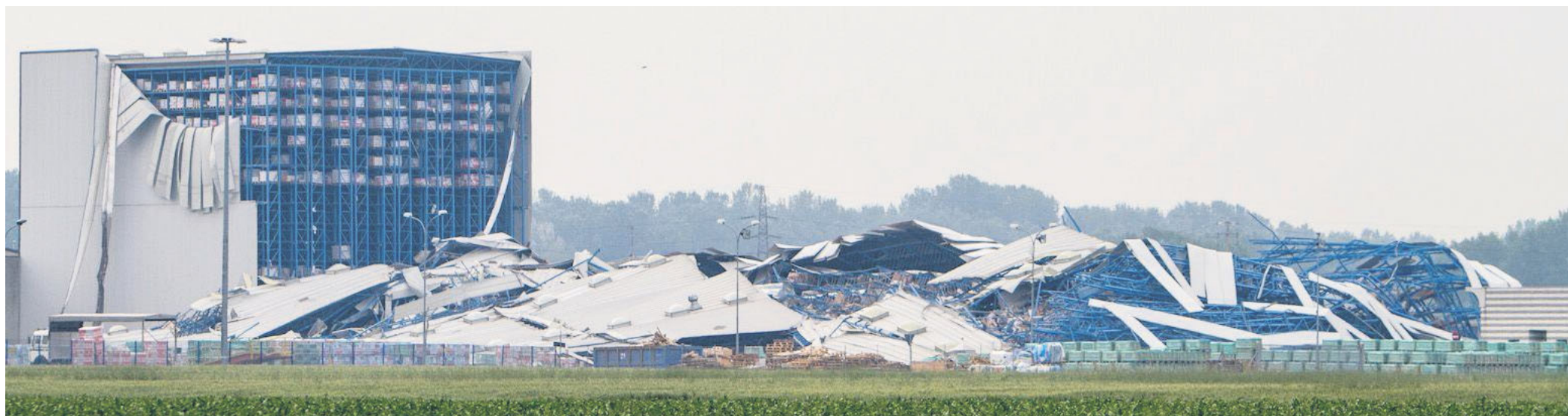
La fabbrica di ceramica crollata sotto la scossa FOTO DI RICCARDO PEZZETTI/EMBLEMA
